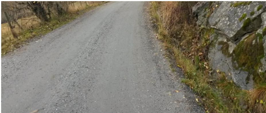
Figur 27 Manglende grøft der det er behov for å sprengre for å lage grøft
