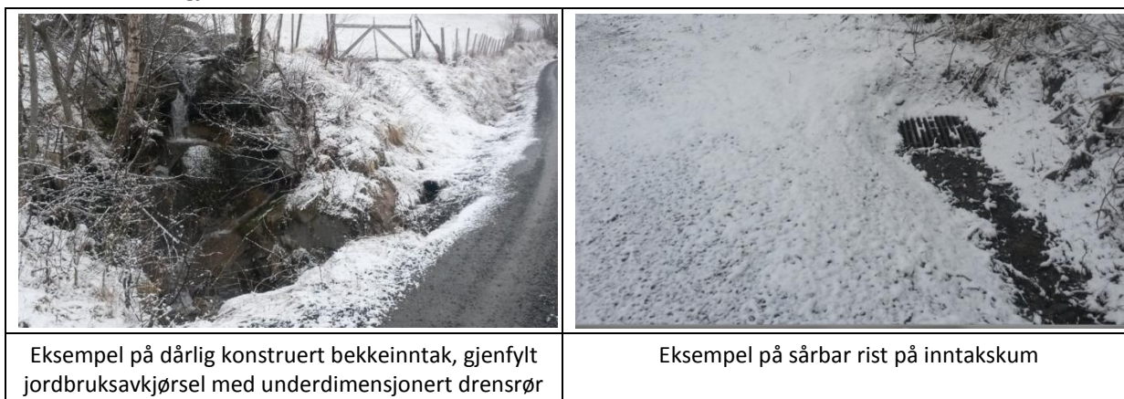
Figur 26 Eksempler på dårlig konstruert bekkeinntak og rist
