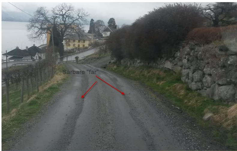
Figur 25 Manglende tverrfall på vei med påfølgende erosjonsskade i hjulspor (fra Henjavegen)
