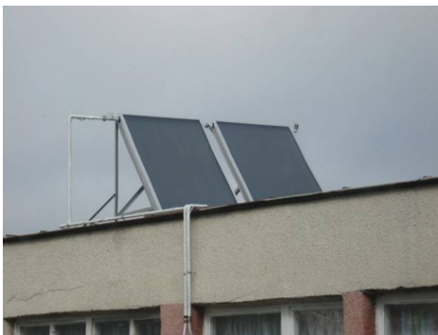
Solpaneler smiler mot himmelen. (Foto: Dobrich kommune)
